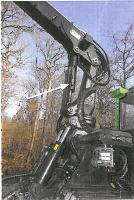
Ein zusätzlich angeschweißtes Stückchen Flachstahl (Pfeil) schützt die Verschraubung des Hubzylinders.
